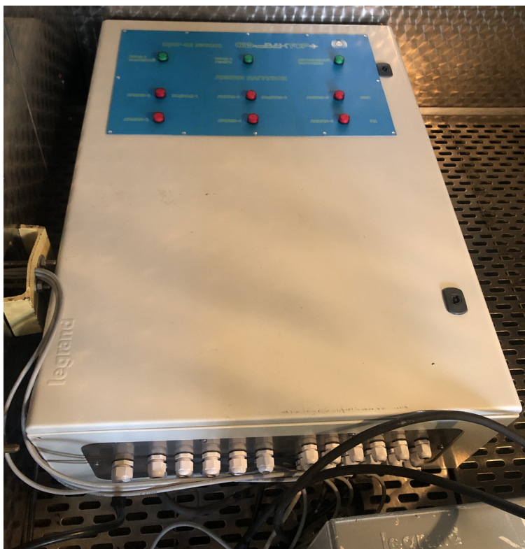
Щит питания (ЩПУ-02)
